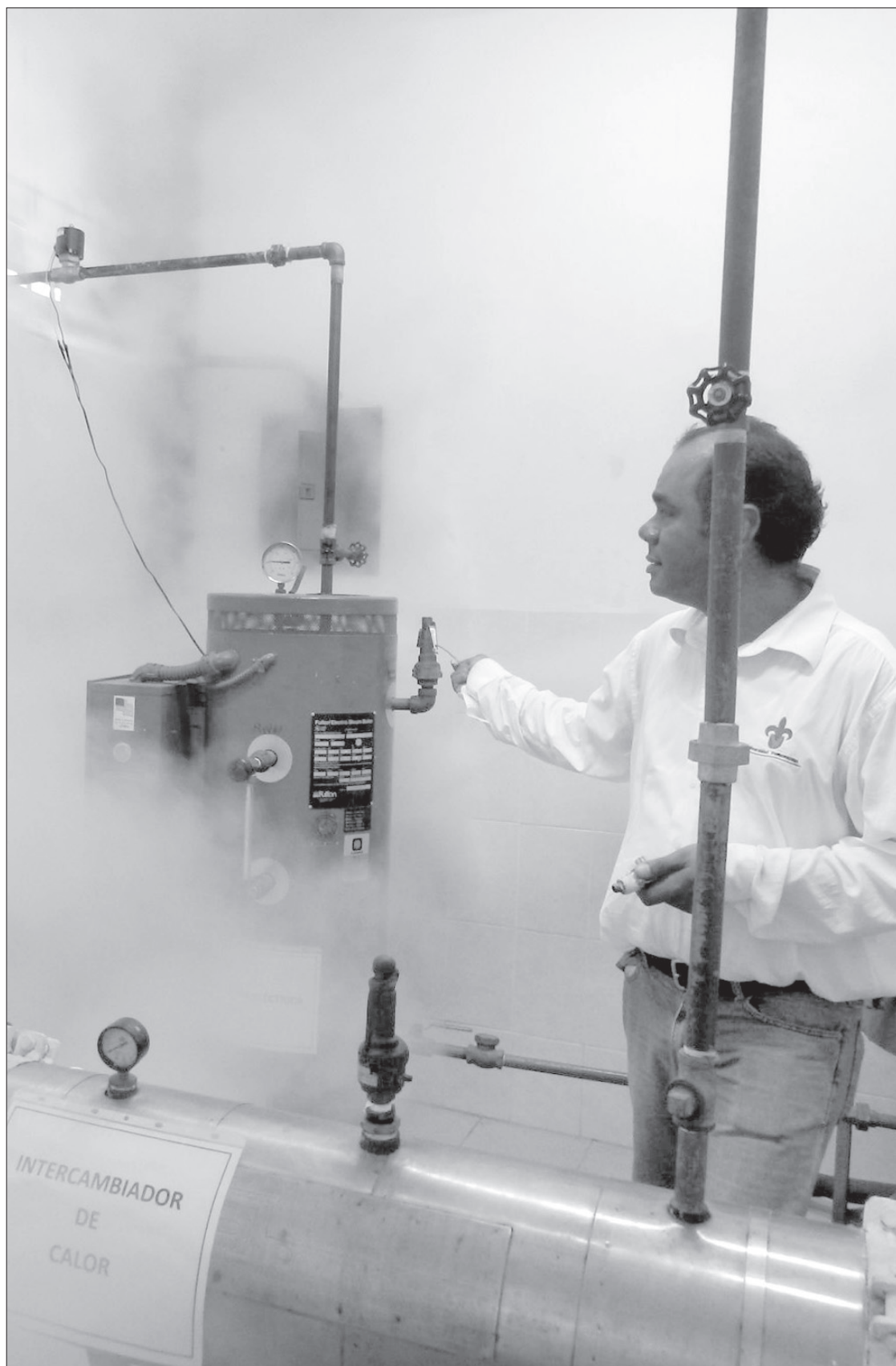
Automatización y creación de una planta de vapor
